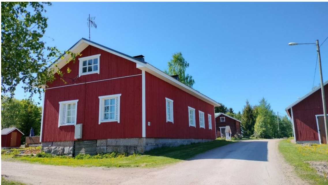
Kuva 12 Huntun nykyinen päärakennus on vuodelta 1883. Kuvassa pystylautojen peiterimoitus puuttuu julkisivuremontin jäljiltä.
