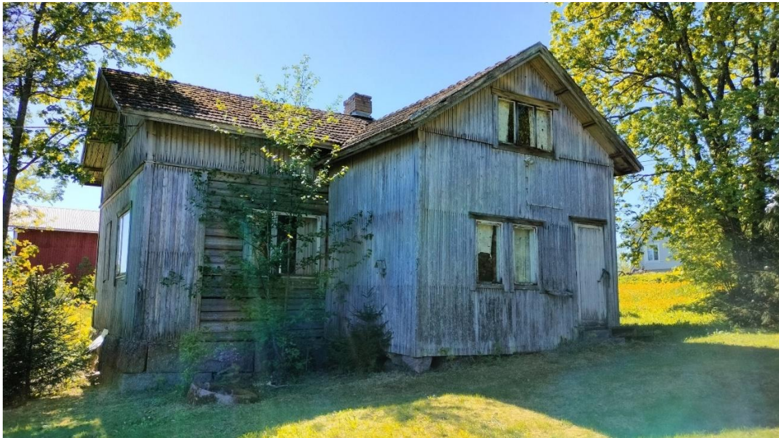
Kuva 36 Rantasalmen asuinrakennus (tilan vanha päärakennus on jo purettu) on vuodelta 1923. Tyhjillään oleva rakennus on heikossa kunnossa.
