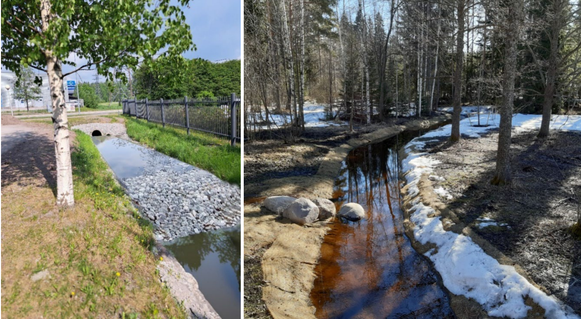
Kuva 13. Vasemmalla havainnollistus ojan yhteyteen toteutetusta väliaikaisesta suotopadosta kiintoaineksen poistamiseksi työmaavesistä. Oikealla eroosiosuojakankaalla suojattu oja. © Destia Oy 2024.
